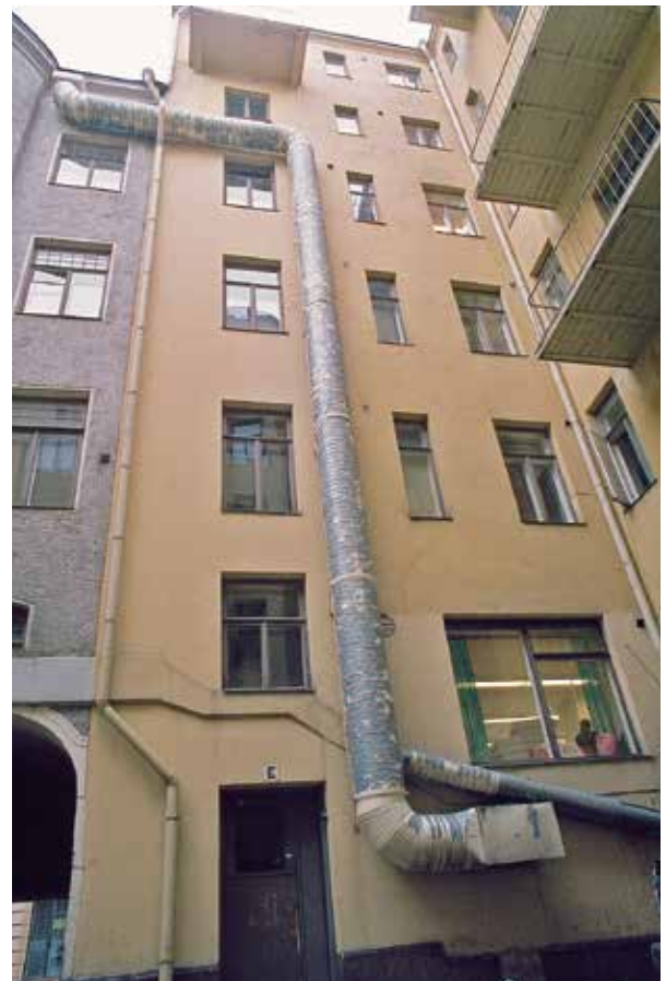
Kuva 2. Salakavala peltimatohyökkäys ullakon kautta pihajulkisivua pitkin pohjakerroksen seinästä sisään.
