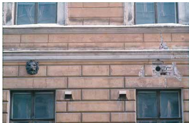
Kuva 8. Yksi 1870-luvun koulun julkisivuleijona on luopunut paikastaan. Takaa on paljastunut ulkoseinän lävistänyt peltimadon pätkä. Mato oli saatu katkaistua sisäpuolelta. Kanava jatkui välipohjassa puurakenteisena ja edelleen pystykanavana ilmanvaihtouuniin takana. Leijonapäätsisäänhengittivät aikoinaan luokkahuoneisiin korvausilman, jonka pystyuunit esilämmittivät samalla kun poistivat ilmaa tulipesän kautta.
