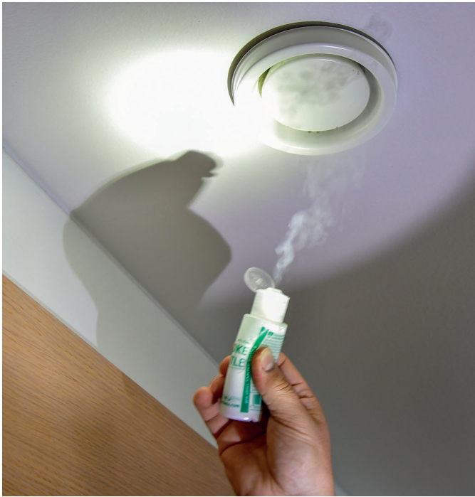
Savumittausten avulla voidaan tutkia ilmanvaihdon toimivuutta.
