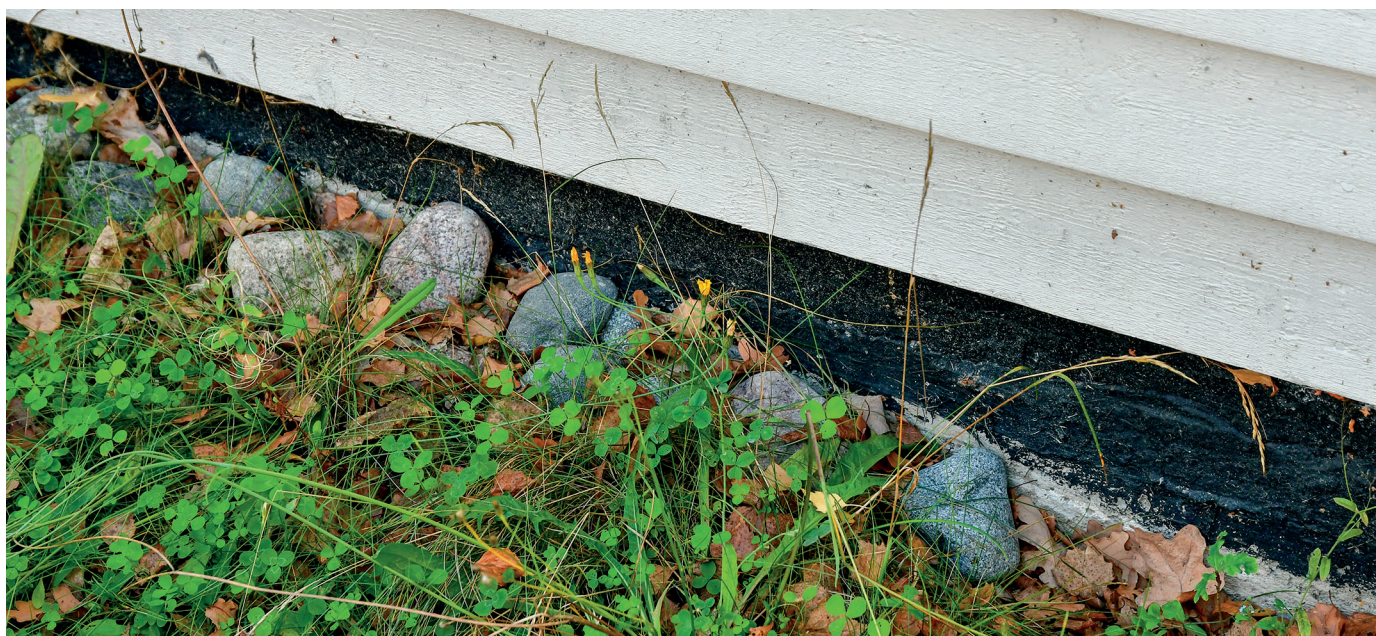
Puurakenteisen sokkelin yläreunan pitäisi olla nykyohjeistuksen mukaan vähintään 30 senttimetriä maanpinnan yläpuolella, mutta tässä tapauksessa etäisyys jää monin paikoin sen alle. Kyseessä on riskirakenne ja kuntotarkastaja suosittelee tekemään vähintäänkin rasiaporareikäavauksia.
