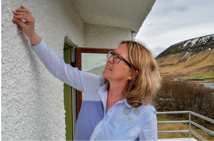
Museojohtaja Guðný Dóra Gestsdóttir on tyytyväinen siitä, että sisäilmakorjausten yhteydessä kunnostettu julkisivu muistuttaa valkoista laavaa, kuten alkuperäisessä rakenteessa.
