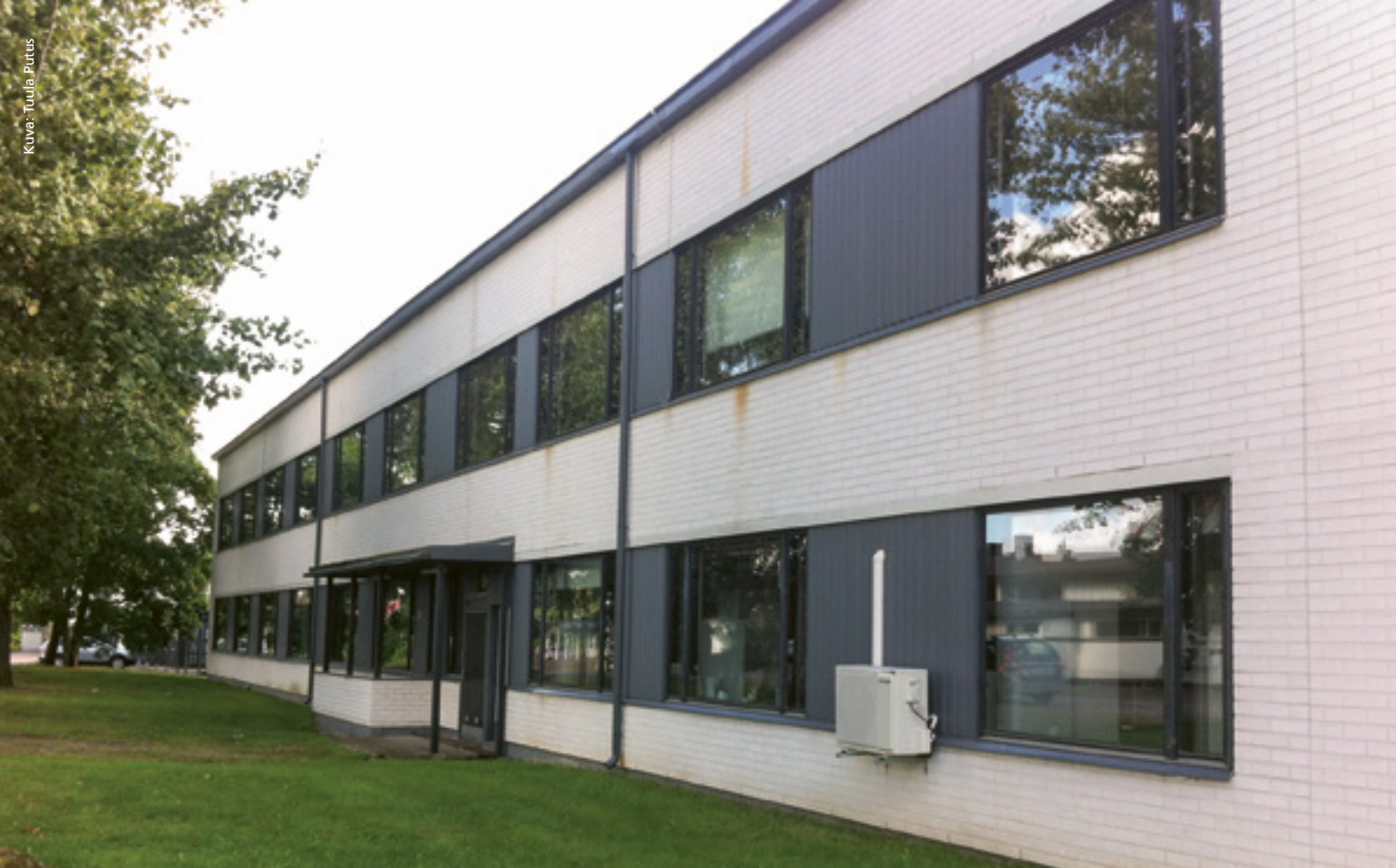
Homevaurion vuoksi käyttökiellossa oleva 60-luvun koulurakennus.
