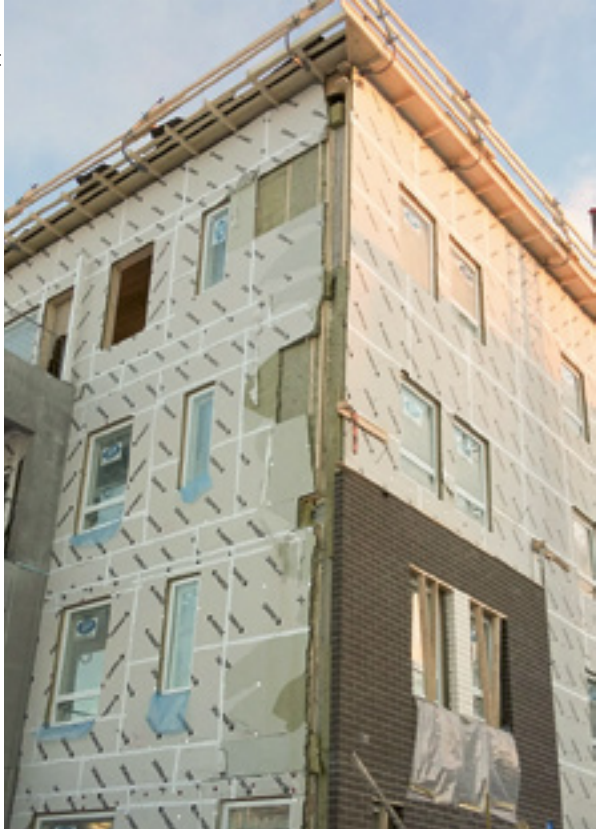
Kosteusvaurio on todennäköinen, kun edes tuulensuojalevyt eivät ole villojen suojana.
